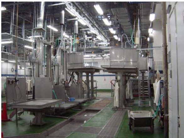
写真 大動物解体ラインのオンレール方式
