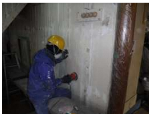
中部エントランス付近天井・漏水部・鋼壁補修
