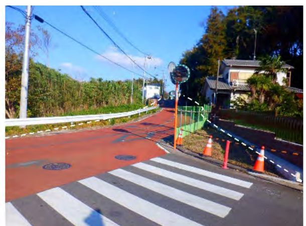
歩道整備・交差点改良 市道下瀬谷第438号線(瀬谷区宮沢三丁目)
