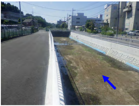
護岸改修、暫定貯留部整備、橋梁新設 (帷子川：旭区川井本町)
