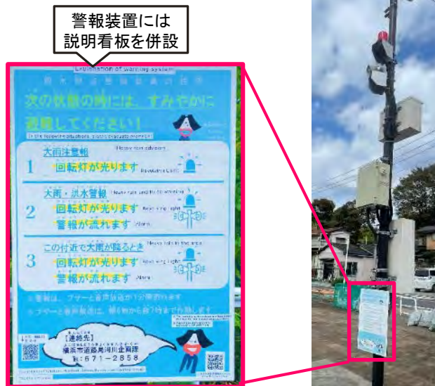
親水拠点警報装置
