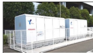
【自立型水素燃料電池システム】
