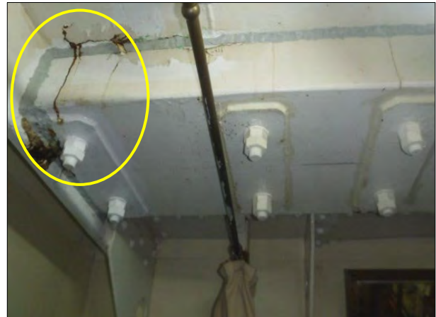
【凹甲板左舷ボラード下部漏水部分（丸部分）】
