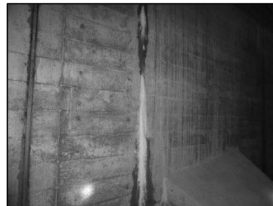
鳥山川遊水地 壁面のひび割れ
