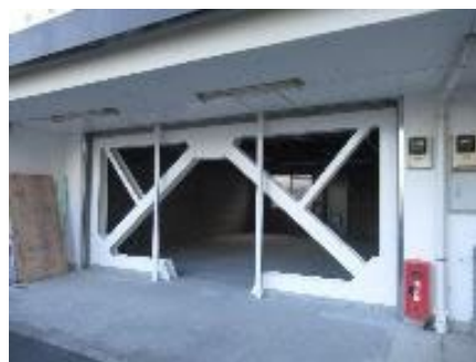
<マンションの1階ピロティ部分に耐震ブレースを新設した事例>
