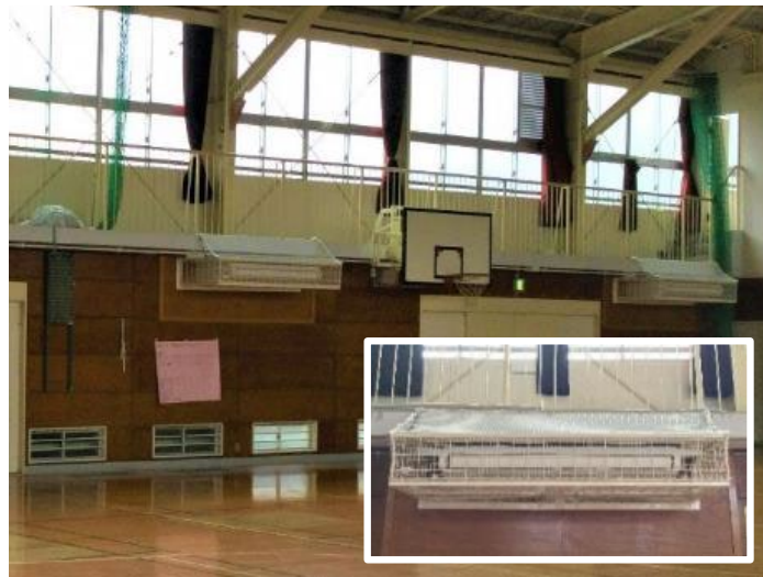
<体育館空調設置例>
