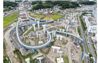
横浜環状南線・横浜湘南道路の整備 (仮称栄IC・JCT)
