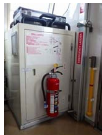
運転台継電器盤設置場所
