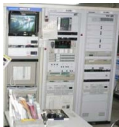
■防犯モニター、非常放送機
