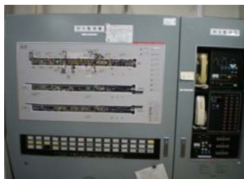
■自動火災報知設備
