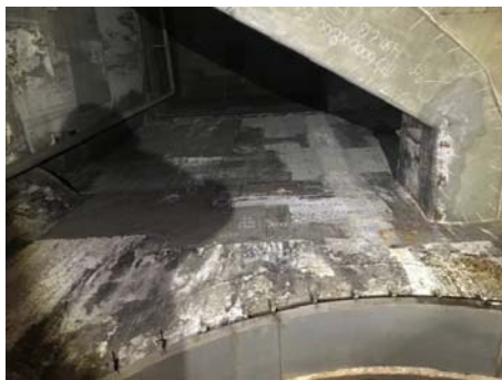
▲通風孔の劣化状況
