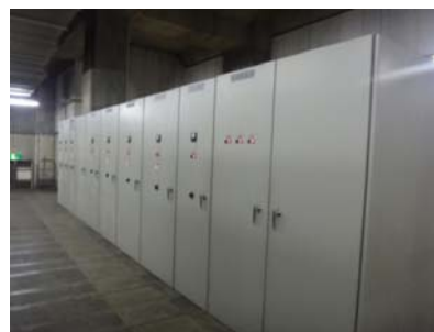
直流き電設備
