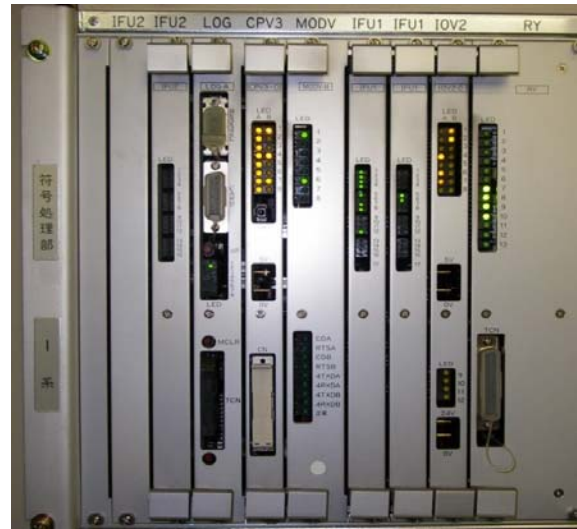
図2:ATO装置ユニット部
