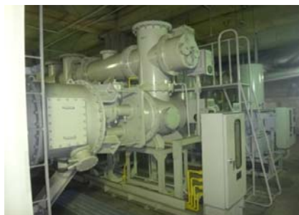
66kV 特別高圧受電設備
