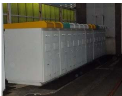
▼直流開閉器盤(C盤)
