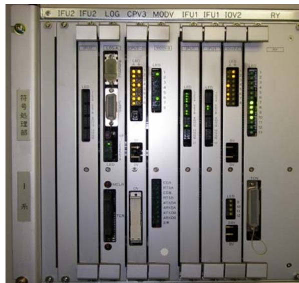
図2: ATO装置ユニット部
