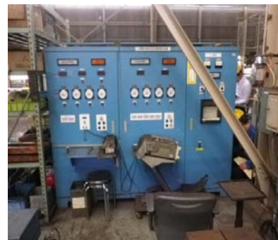
上永谷修繕工場設置の主電動機無負荷回転試験電源盤
