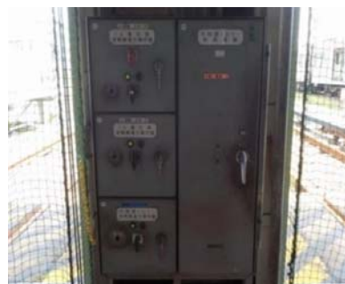
▼現地操作盤(G盤)
