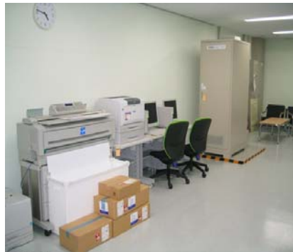
車両管理システム(川和検修区事務室)
