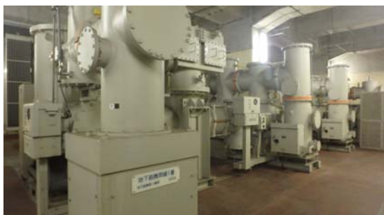
66kV 特別高圧受電設備
