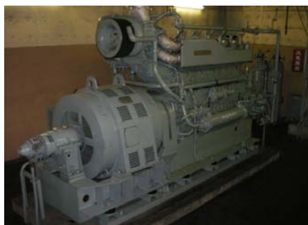
非常用発電機
