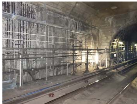
▲下り線の劣化状況
