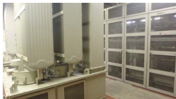
22kV/595V変圧器及び整流器
