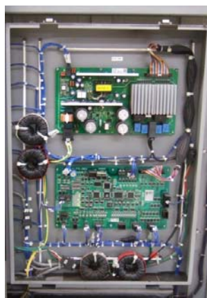
ホーム柵内部基板拡大
