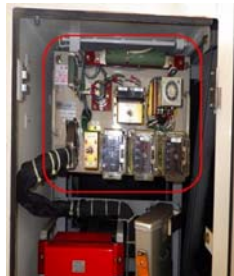
運転台継電器盤(設置状態)
