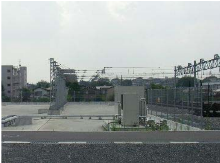
電車線引留柱
