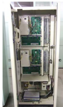
総合制御盤内部
