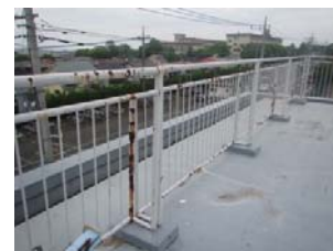
屋上手摺腐食・防水層不具合
