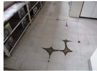
事務室前廊下仕上不良
