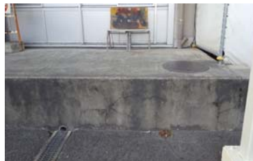
(緑営業所) 破損・通路段差状況
