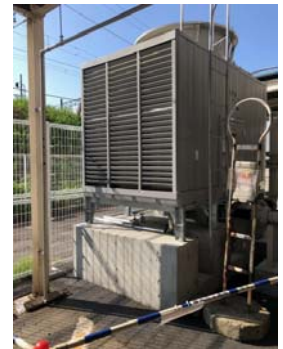
(鶴見営業所) クーリングタワー設置状況
