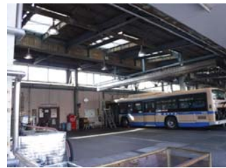
車庫内鉄骨錆状況
