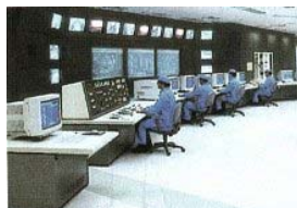
工場内（中央管制室）
