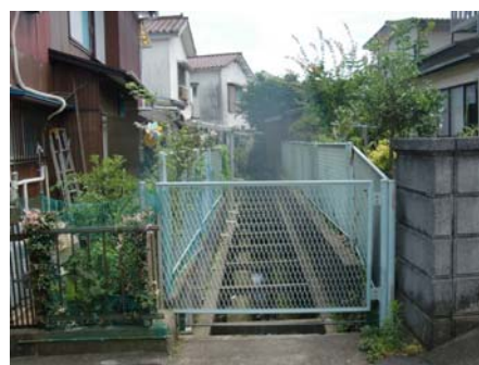
写真②【既存水路の状況】 既存水路は能力が不足しており、浸水リスクが高い。 既存水路と家屋が隣接しており、水路の拡幅は困難。
