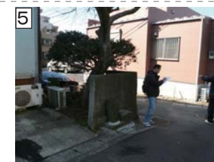
5 民家の塀の外側にあり、車などがぶつかる危険性がある。隣接する町内会館の敷地内への移設も検討すべき。
