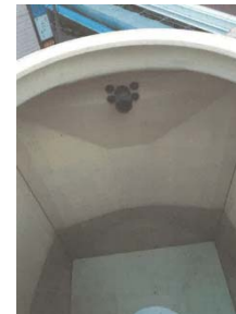
写真8 高置水槽内部
