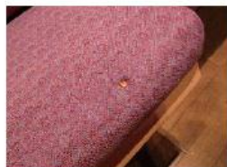
【ホール座席/座面の破損・汚損】
