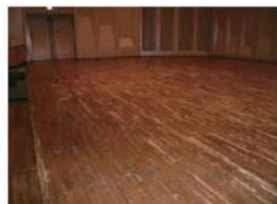
【ホール舞台床面の劣化】
