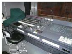
【照明調光卓/故障部品入手困難】
