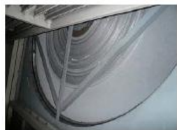
【空調設備/著しい経年劣化】
