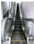
【エスカレーター/減速機の劣化】
