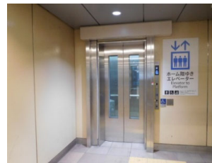
▲更新したエレベーター
