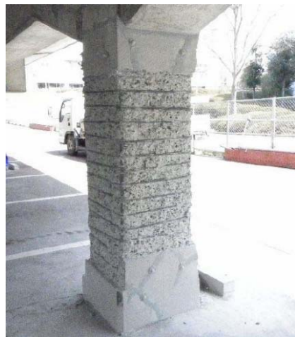
震災で損傷した高架橋柱（提供：仙台市） （剥落の恐れがある表面を修復途中で落とした状態）
