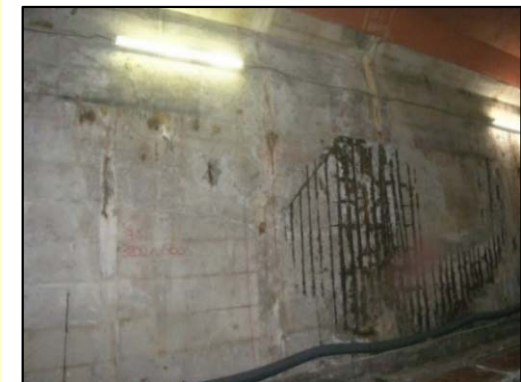
構造物劣化状況
