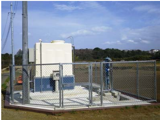
[写真] 電気設備及び貯水槽 (緑区/向原地区畑地かんがい組合)
