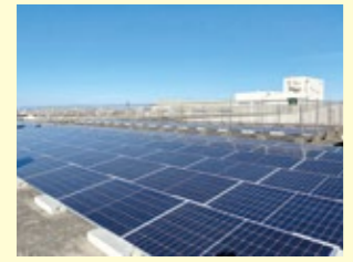
学校に設置した太陽光発電設備
