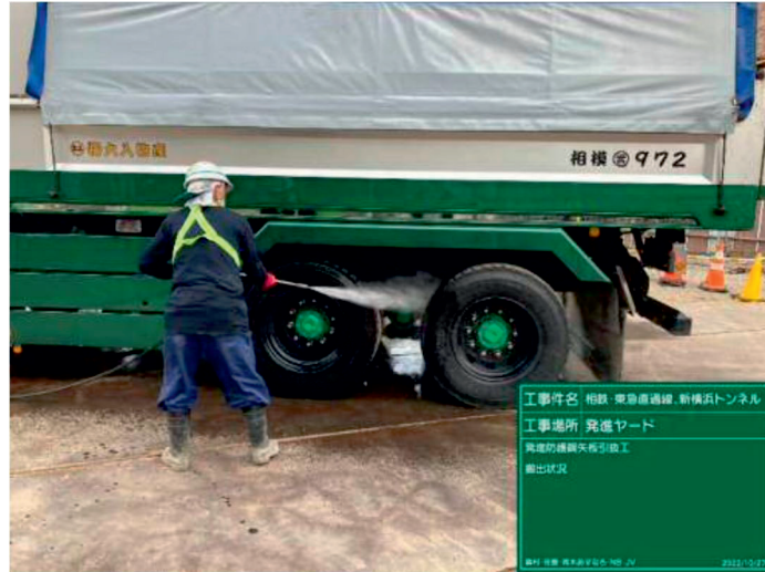
写真 2. 4. 4-2(3) 環境保全のための措置の実施状況（工事用車両のタイヤ洗浄）
