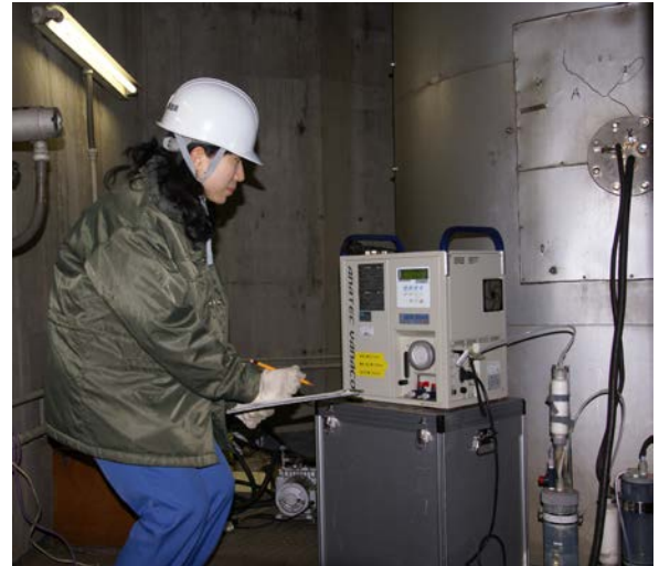
ばい煙の測定による立入検査
