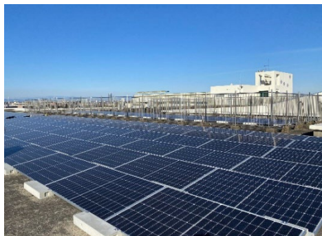
PPA事業の活用により導入した太陽光発電設備
