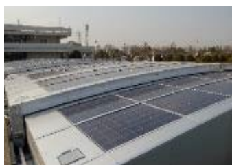
太陽光発電設備(小雀浄水場ろ過池)
