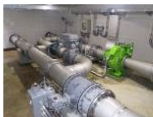
小水力発電設備(恩田配水池)
