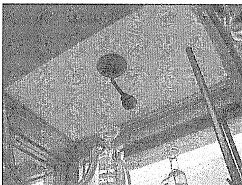
図-19 フード内の上部の噴射ノズル
