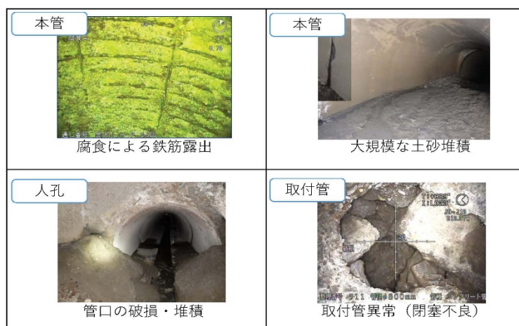
図 2 中大口径管の異常箇所事例
