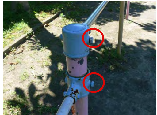
▲ ボルトの飛び出し
