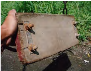
腐朽の初期段階
