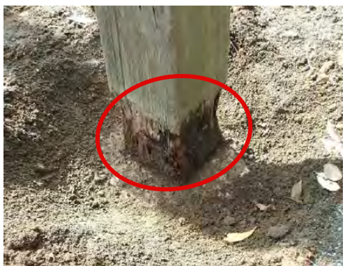
▲ 根際部の腐食（木製柱）
