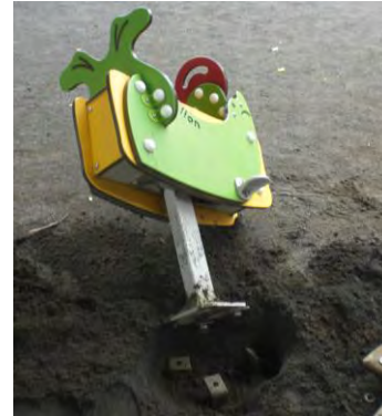
▲ ボルト欠損、アンカープレート破断
