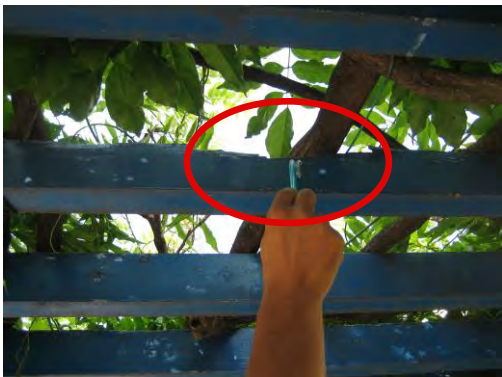
▲ パーゴラ 桟木腐食
