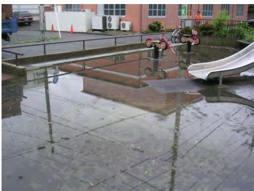
▲ 広場 排水不良
