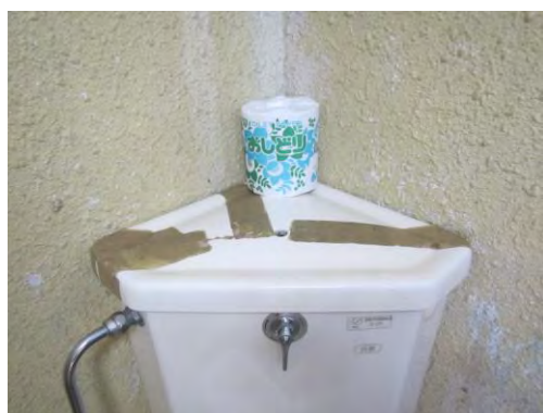
▲ 便所 タンク蓋破損
