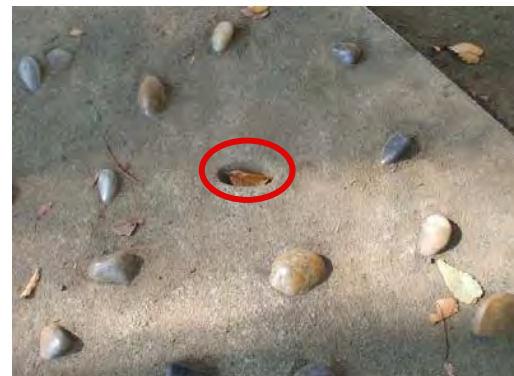
▲ 踏み石の欠落（健康歩道）
