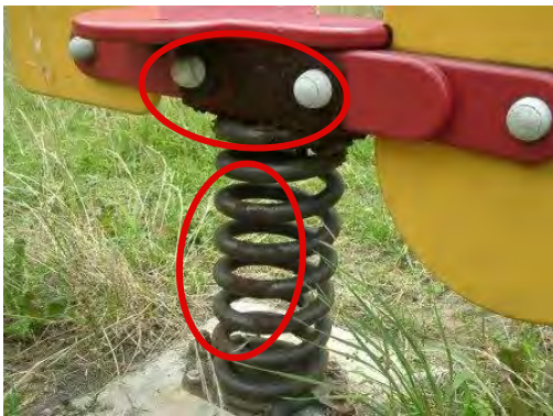
▲ スプリング及び上物取付金具の錆
