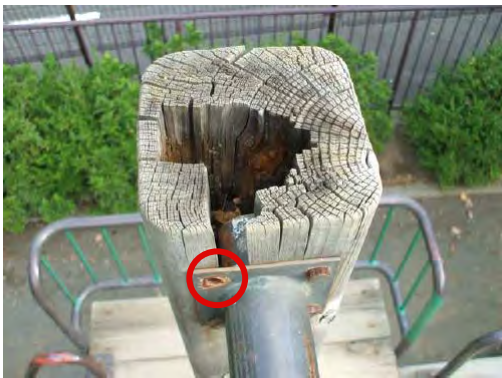
▲ 支柱天端の腐朽及びボルトの欠落
