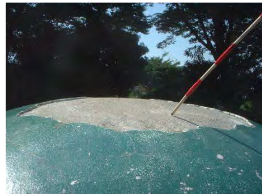
▲ モルタル部の破損
