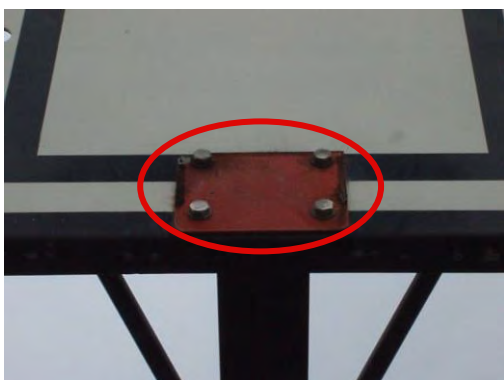
▲ バasketボールゴール溶接部の破断
