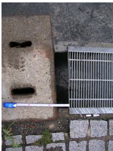
▲ グレーチング 隙間
