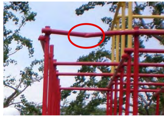
▲ 横部材の変形（曲がり）
