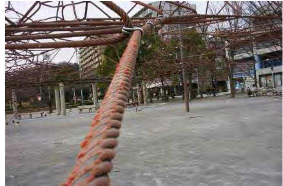
▲ ザイルネット登はん遊具のワイヤーの露出 (鋭利な状態の場合は怪我をする恐れあり)
