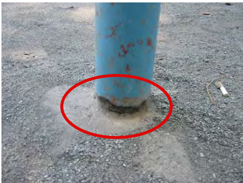
▲ 支柱地際部の腐食及び亀裂
