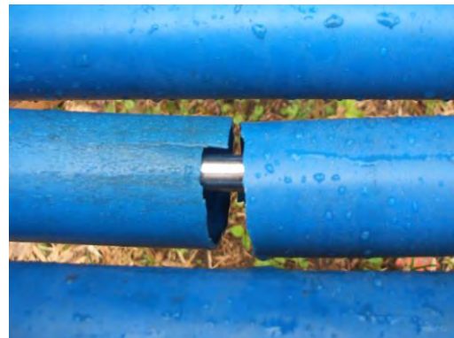
▲ ローラーすべり台のローラー破損
