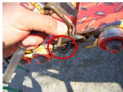
▲ 吊り橋チェーン摩耗
