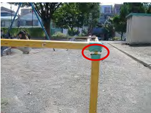
▲ ブランコ安全柵の継手金具の割れ
