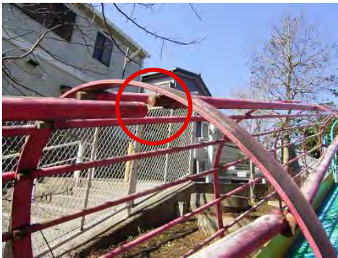
▲ 落下防止柵の接合部の破損
