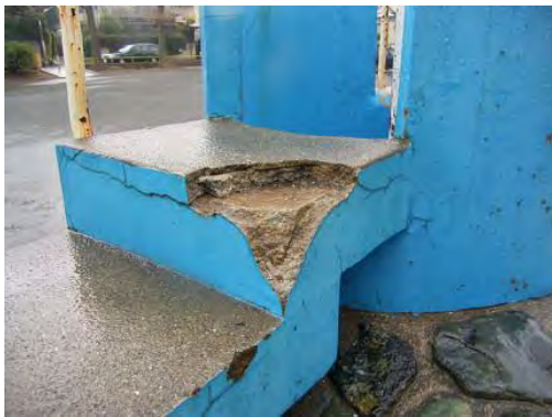
▲ コンクリートの破損
