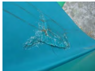
FRPの劣化状況
