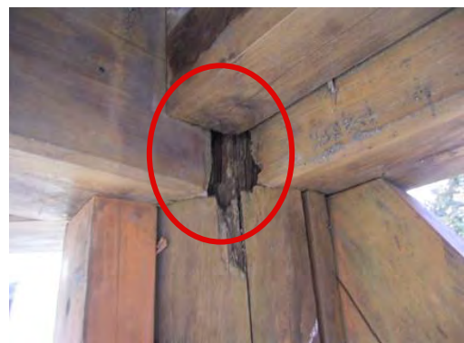
▲ 梁及び支柱の腐朽
