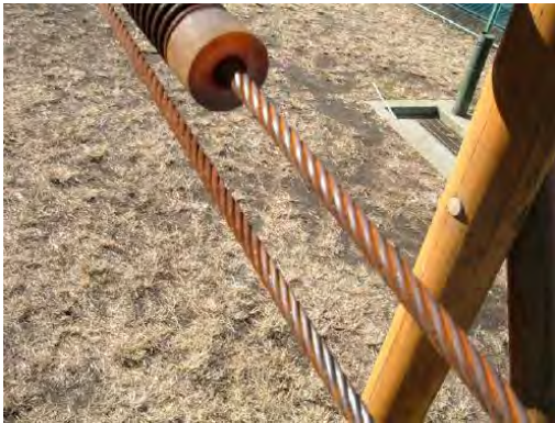
▲ ケーブルの腐食
