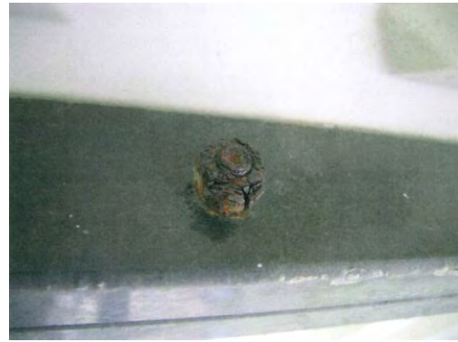
▲ パーゴラ ボルトさび
