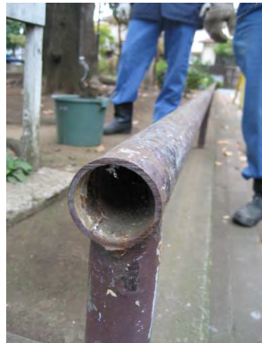
▲ パイプ柵 端部欠損
