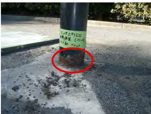
▲ あん馬ベンチ根際部の腐食（鋼製柱）
