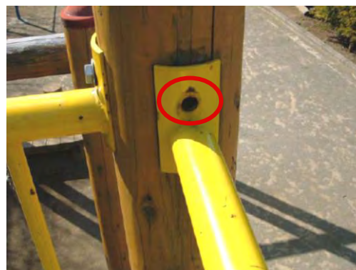
▲ 安全柵取り付け金具の欠落
