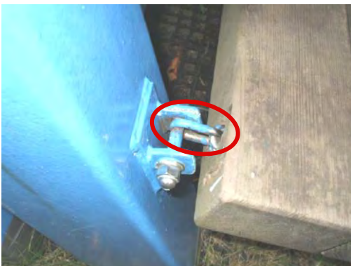
▲ 吊り橋取り付け部チェーンの摩耗
