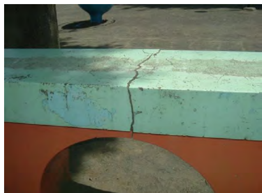
▲ コンクリートの亀裂
