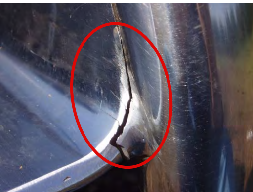
▲ 滑り降り部端部の亀裂
