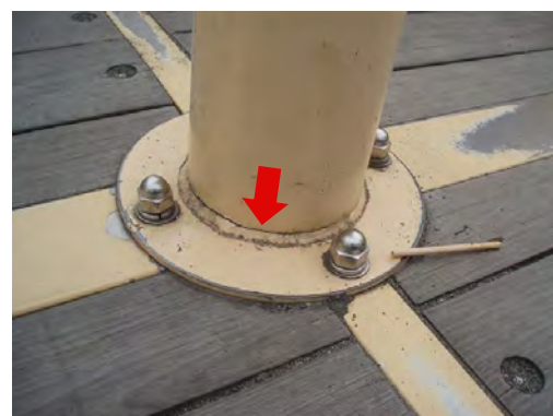
▲ フランジ溶接部の亀裂
