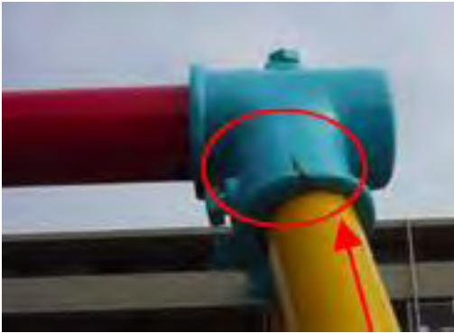
▲ 継ぎ手金具の割れ
