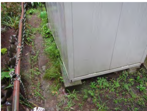
▲ 倉庫 基礎不良
