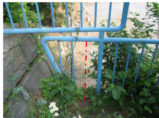
▲ 縦格子柵 部材欠損
