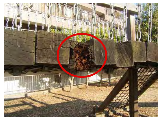
▲ 吊り橋部材の腐朽
