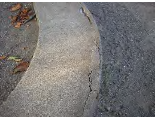
▲ 人研ぎ仕上げの割れ
