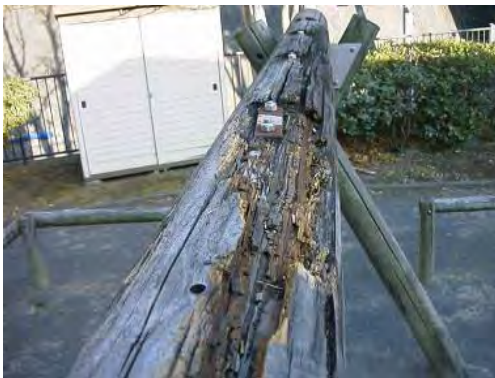
▲ ブランコ梁の腐食（木製）
