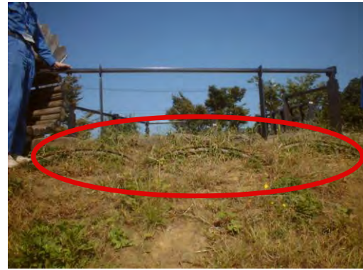
▲ 法枠金物の露出
