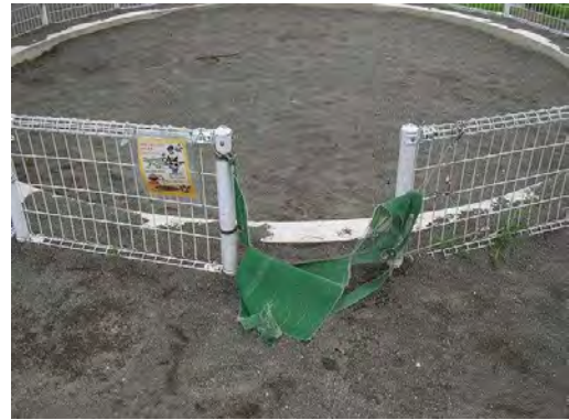
▲ 砂場柵入口の破損
