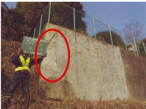
▲ 擁壁表面剥れ
