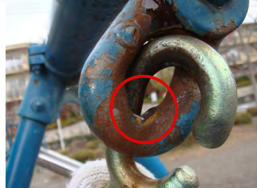
▲ 吊り金具の摩耗
