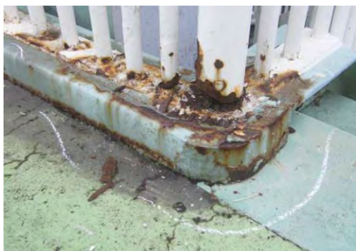
▲ 橋梁高覧（手摺り）の腐食
