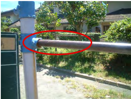
▲ 継ぎ手部分及び握り棒の錆
