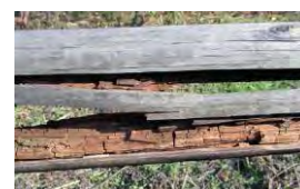
木材の腐朽(褐色腐朽)
