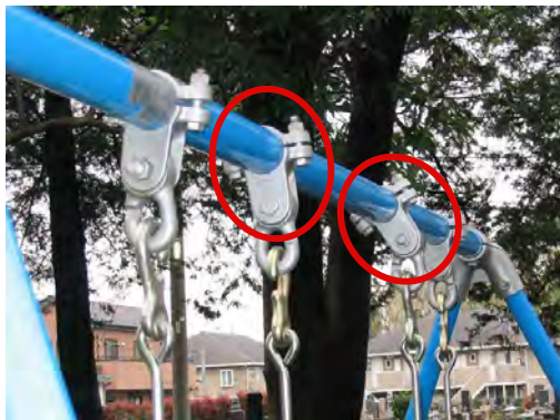
▲ 吊り金具のずれ
