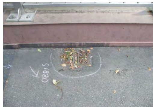
▲ 橋梁の排水施設土砂詰り
