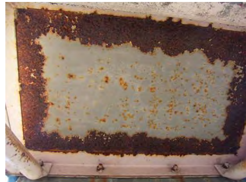
▲ 踊り場（裏側）の腐食
