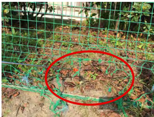
▲ 防球ネット ネット破れ
