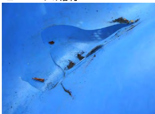
▲ スライダー滑降面の破損
