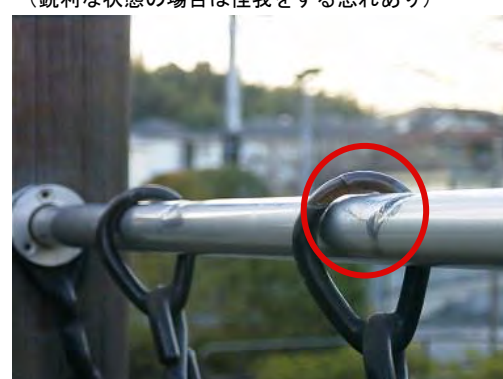
▲ チェーンネット取付金具及びパイプ摩耗
