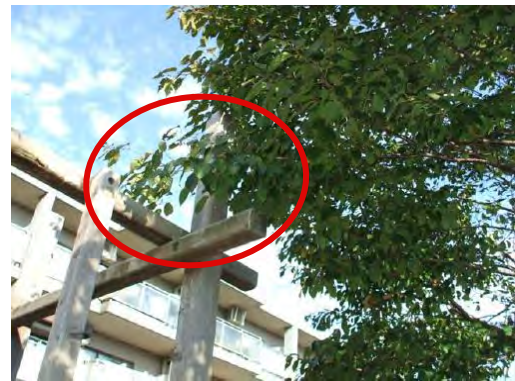
▲ 樹木の枝が支障となっている
