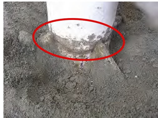
▲ 根際部の腐食及び亀裂
