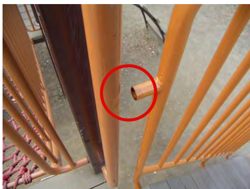
▲ 安全柵取り付け金具の脱落
