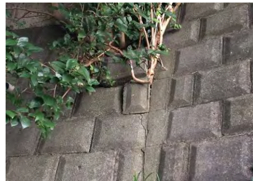
▲ 落下の危険があるブロック
