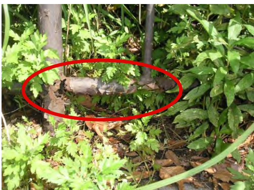
▲ パイプ柵 部材腐食
