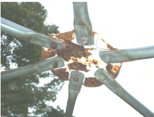
▲ 接続金具の腐食
