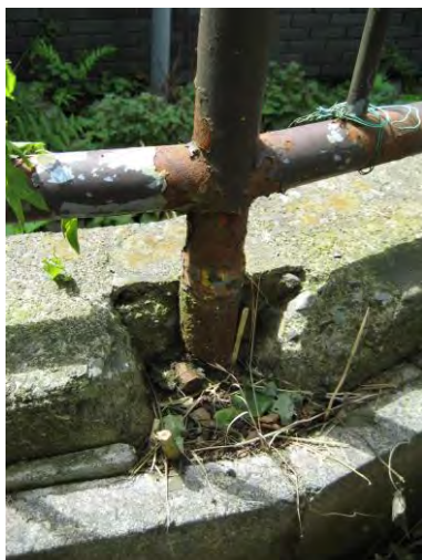
▲ パイプ柵 基礎破損
