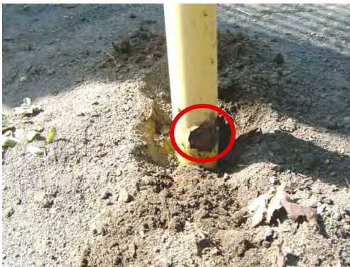
▲ 根際部の腐食（金属柱）
