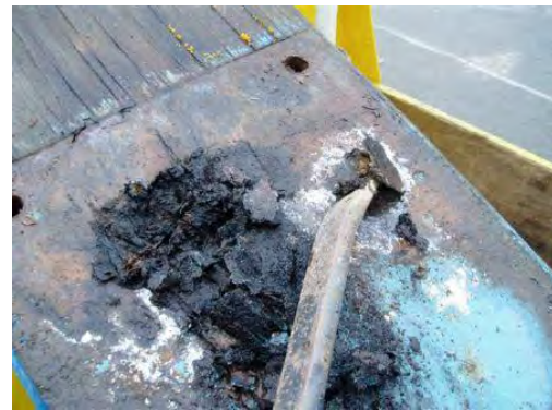
▲ 板の腐食状況
