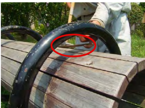
▲ 座板表面の割れ
