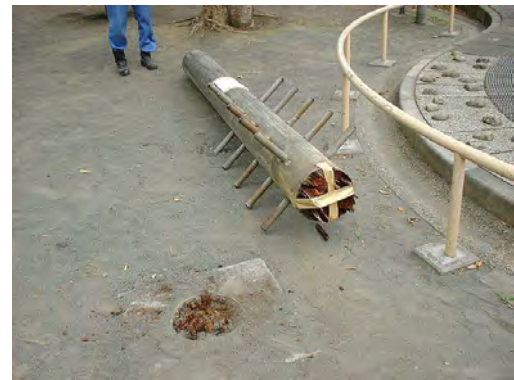
▲ 根際部の腐食による倒壊（木製柱）
