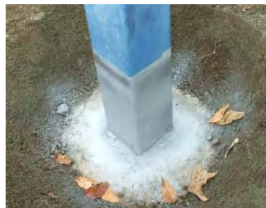
◀ 柱の根際部の 防食テープ 措置事例
