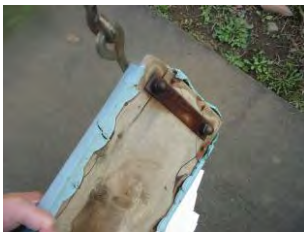
樹脂系素材の劣化状
