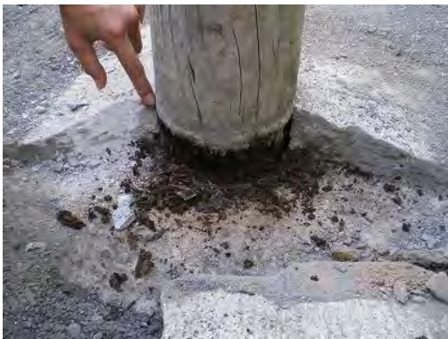
▲ 根際部の腐食（木製柱）
