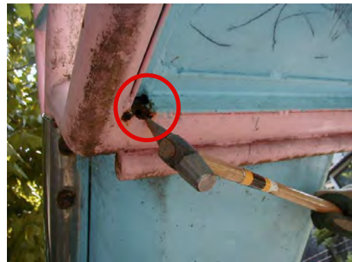
▲ 踊り場の腐食
