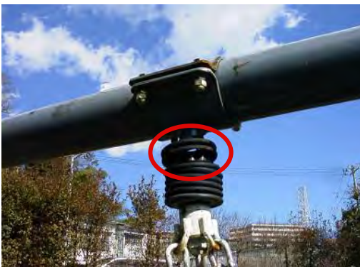
▲ 吊金具カバー破損
