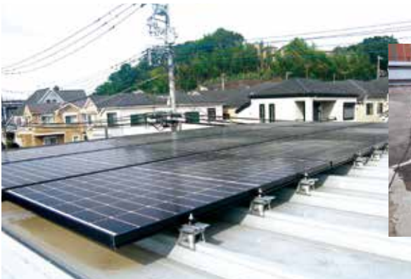
社屋屋上に設置した太陽光パネル
