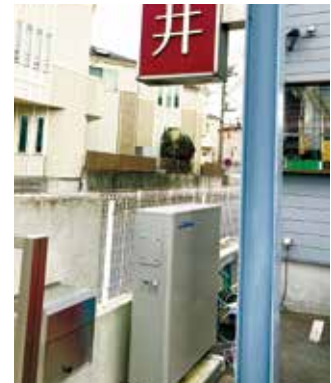
敷地内に設置した蓄電池 (モニター)
