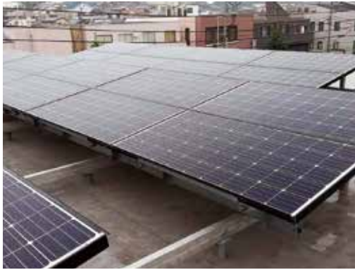
社屋屋上に設置した太陽光パネル
