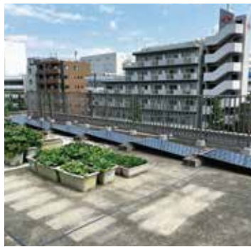
社屋屋上に設置した太陽光パネル
