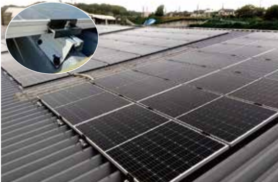
社屋屋上に設置した太陽光パネル
