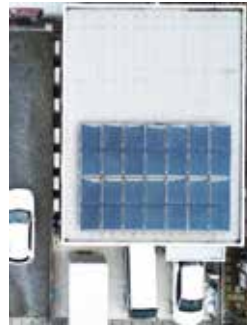
社屋屋上に設置した 太陽光パネル(埼玉営業所)
