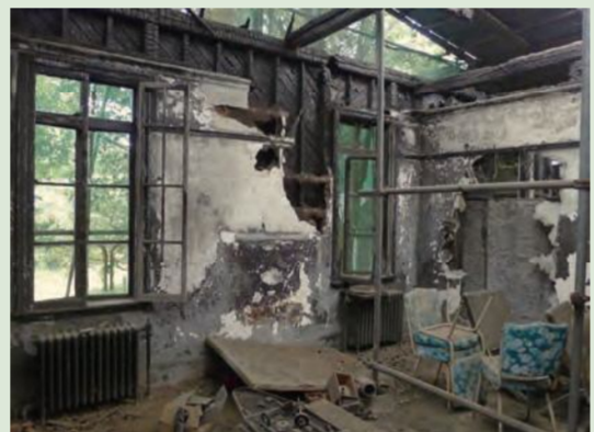
旧モーガン邸内部の焼損状況
