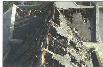
火災直後の屋根の状況
