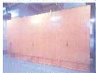
非常用電源施設
