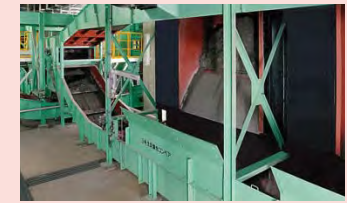
主灰集合コンベア Main ash collection conveyor
