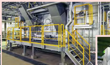
焼却炉本体 Incinerator
