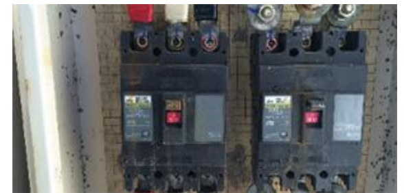
幹線ブレーカー
