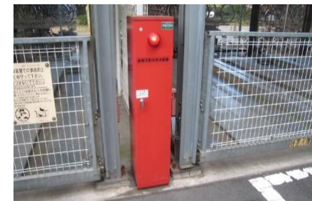
駐車場用消火設備
