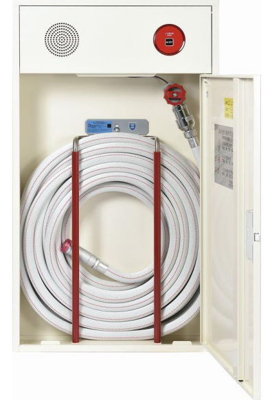
易操作性1号消火栓
