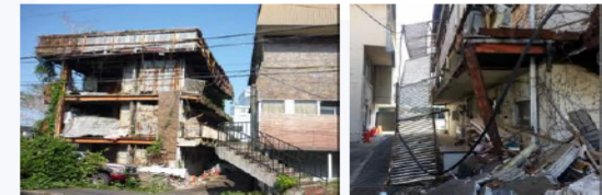
※管理不全マンションの事例（R2、行政代執行により除却）
