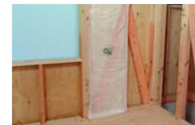
③最初に剥がした防湿フィルムをかぶせ直し、間柱の見附面にタッカーで留めて完成です。
