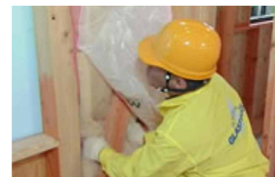
①防湿フィルムを一旦剥がし、筋交いの裏側にグラスウールを入れていきます。
