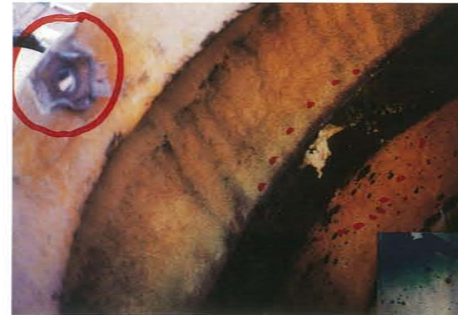
ボルト穴が開いている
