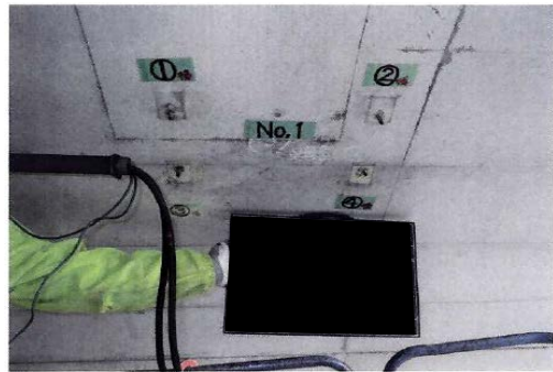
アンカーボルト不良により、照明器具 取外し
