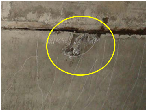
天井部コンクリートのはく離 (入之谷第1 隧道・保土ヶ谷区)
