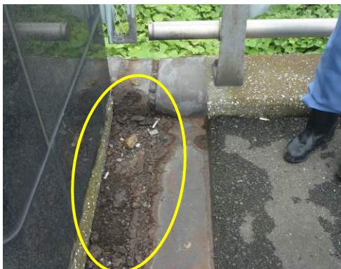
伸縮装置の腐食 (布袋橋・神奈川区)
