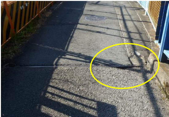
橋梁端部の段差 (舞岡橋・戸塚区)
