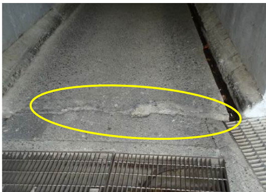
舗装の段差 (上矢部地下道・戸塚区)
