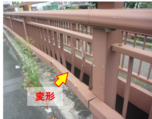
高欄の変形 (旭橋・中区)
