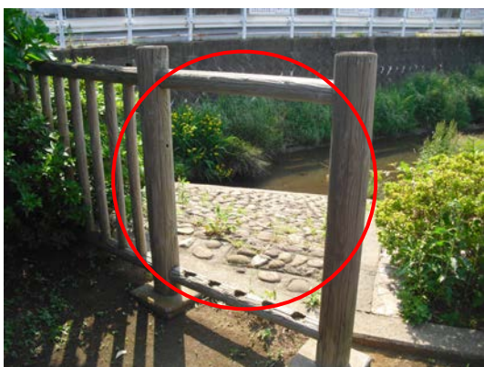
転落防止柵の縦格子抜け (砂田川・港北区)
