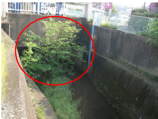
河道内の樹木 (舞岡川・戸塚区)
