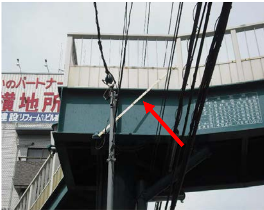
裾隠し板留め金具の脱落 (片倉町歩道橋・神奈川区)
