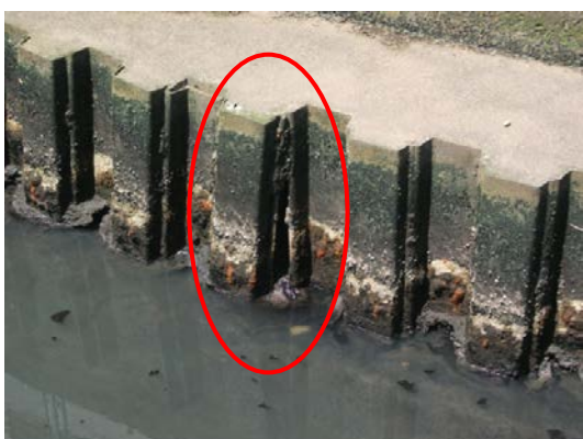
護岸等の補修 (根継ぎ矢板損傷) (入江川・神奈川区)
