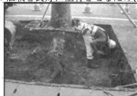
街路樹の根上がりの状況
