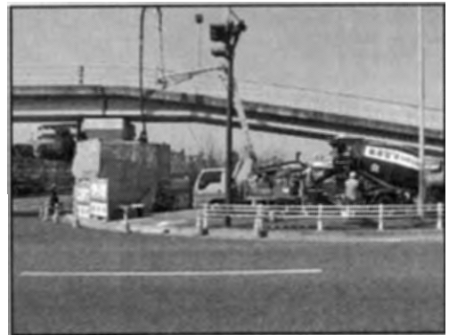
歩道橋の耐震補強の様子（橋脚補強） （ふじ歩道橋：保土ヶ谷区）
