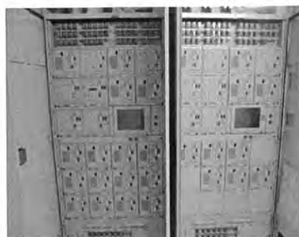
【更新後の ATC 装置】
