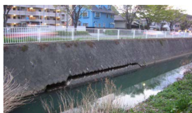
河川護岸の崩壊
