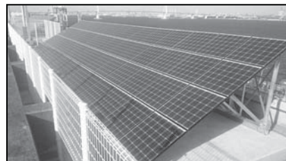
太陽光パネル(Y-CC屋上) ※自立型水素燃料電池システムに接続
