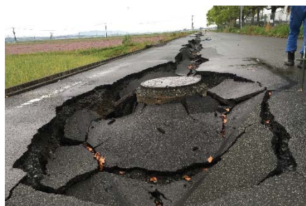
地震による下水道管上部の陥没 (熊本地震)
