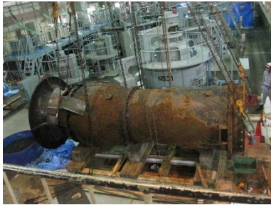
ポンプ再整備前
