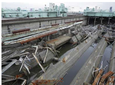
津波により破壊された水処理施設 (東日本大震災)
