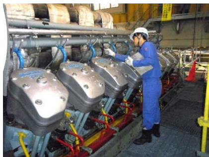
水再生センター施設・設備の点検
