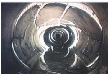
老朽化した下水道管
