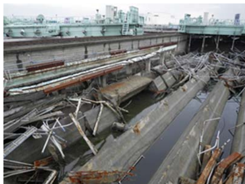
津波により破壊された水処理施設
