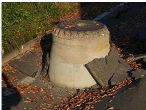
地盤の液状化によるマンホールの浮上
