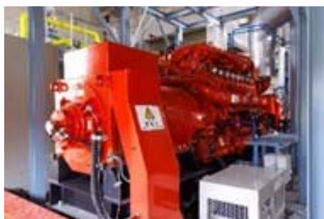
消化ガス発電機
