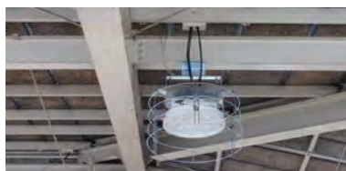
屋内運動場照明 整備例
