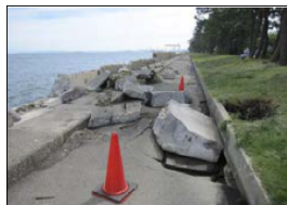
護岸損壊（金沢区）
