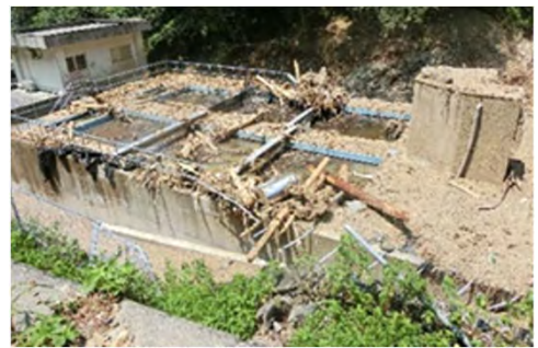
平成30年7月豪雨による 浄水施設の被災状況（愛媛県宇和島市）
