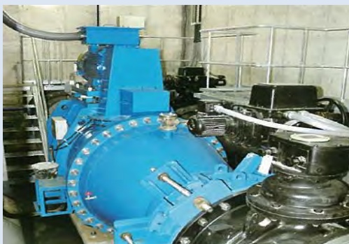
小水力発電（川井浄水場）
