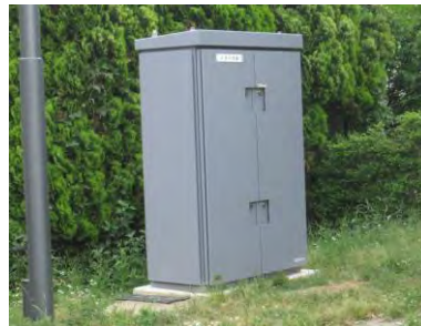
水道計測設備
