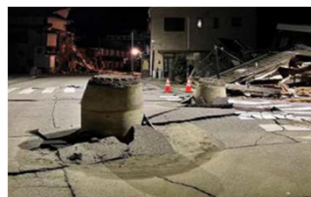
マンホール浮上(輪島市)
